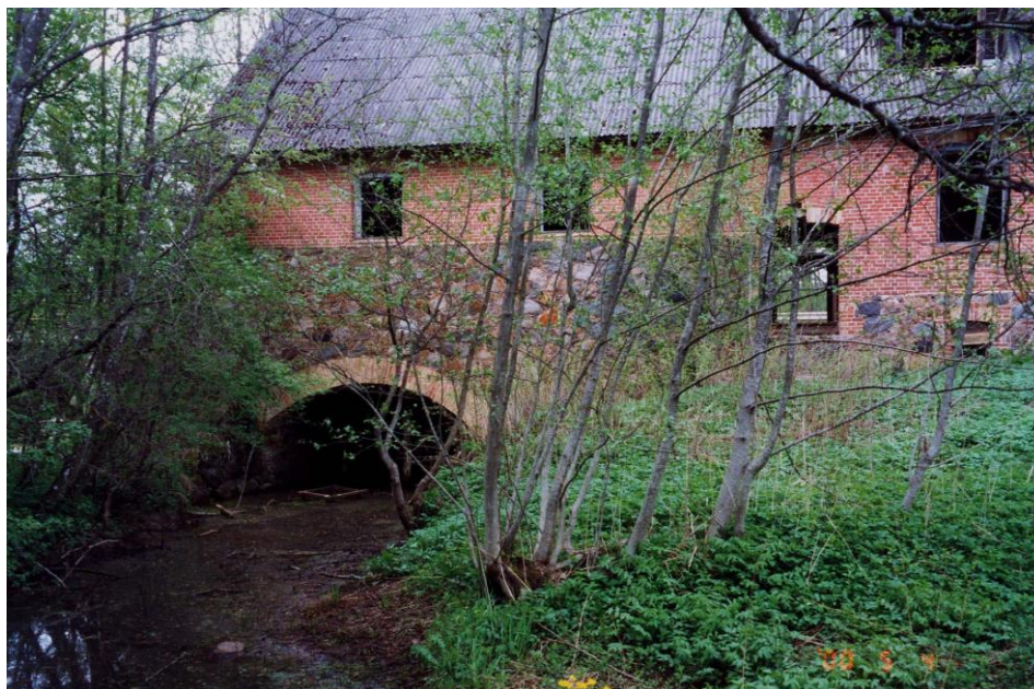
Joon. 2.3.10.2. Koorküla vesiveski alavee vaade, esiplaanil turbiinikanali väljavoolusuue
