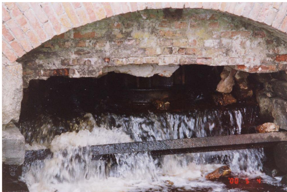
Joon. 2.3.12.2. Turbiinikanali kaudu toimub läbivool, mis viitab varjade halvale seisule, lekkeläbivool tekitab talvel olulist kahju ehitise konstruktsioonidele.
